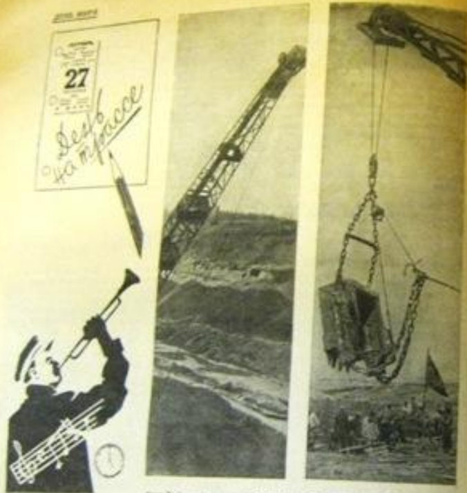
Иван Уфимов переносит обелиск из старого рынка. Две тысячи тонн идет путь до моря. Высота обелиска — 40 метров, диаметр — 1 метр 200 мм
